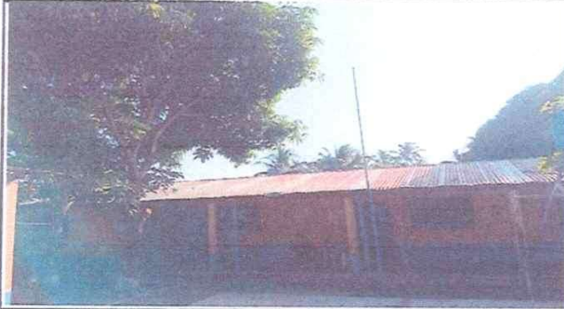
Foto1: TECHO: Se cambiará la lámina ya que está en mal estado, por lámina Troquelada.
