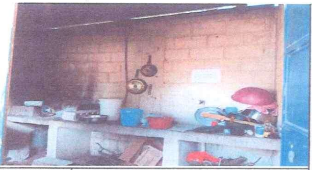
Foto 5: COCINA: Área de cocina sin piso, con paredes en mal estado, lámina en mal estado, sin chimenea, sin hornillas.
