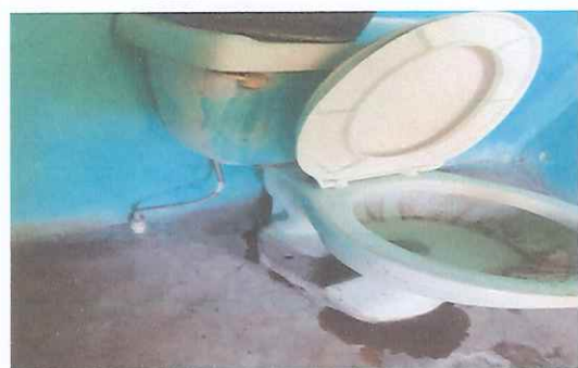
SANITARIOS A MEJORAR
