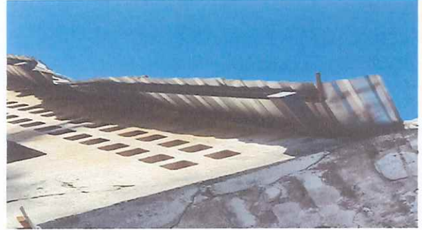
Foto No. 2 Techo de un aula, en mal estado
