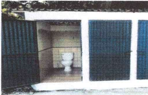
Foto1: Servicios Sanitarios en mal estado
