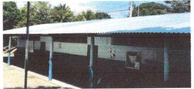
Foto 2: Lámina en mal estado, se sustituirá
