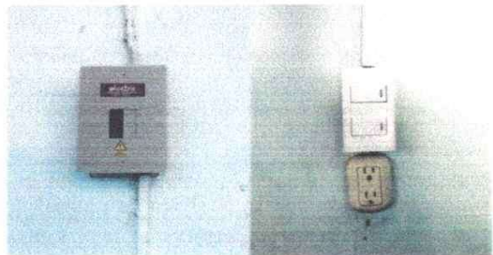
Foto 6: Sistema electrico en mal estado
