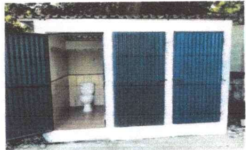
Foto 6: Servicios Sanitarios en mal estado
