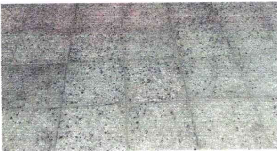
Foto 5: Piso en mal estado
