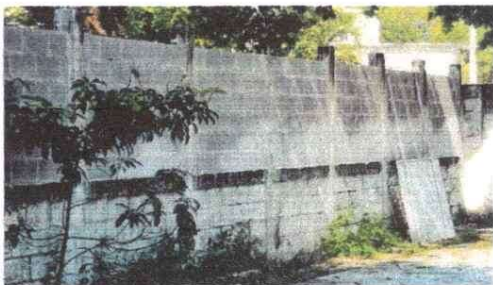
Foto 4: Muro perimetral en mal estado
