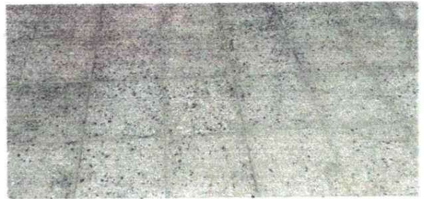
Foto 4: Piso en mal estado
