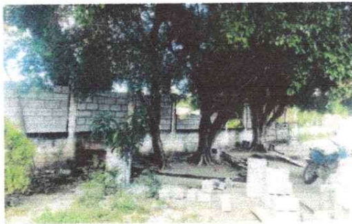
Foto 4: Muro perimetral en mal estado
