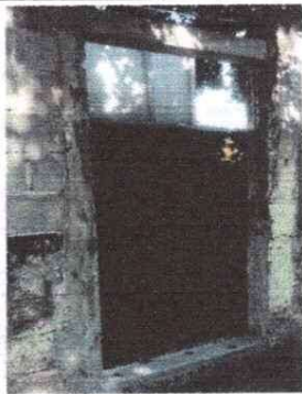
Foto 3: Puerta en mal estado, se sustituirá
