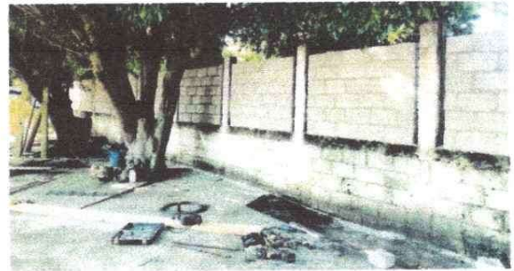
Foto 4: Muro perimetral en mal estado
