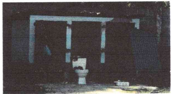
Foto 6: Servicios Sanitarios en mal estado
