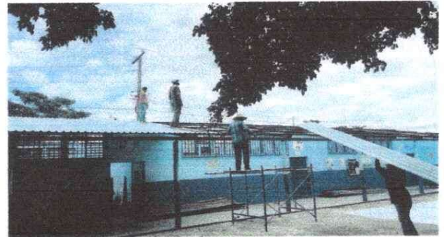
Foto 2: Lamina en mal estado, se sustituirá
