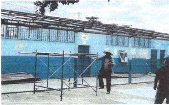
Foto1: Lámina en mal estado, se sustituirá
