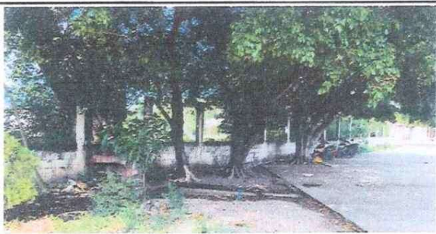
Foto 5: Muro perimetral en mal estado
