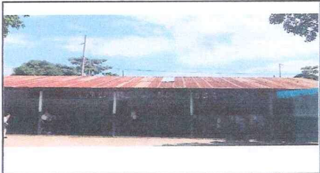
Foto 2: Lamina en mal estado, se sustituirá
