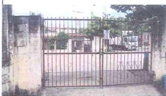
Foto 2: Porton en mal estado, se le dará mantenimiento
