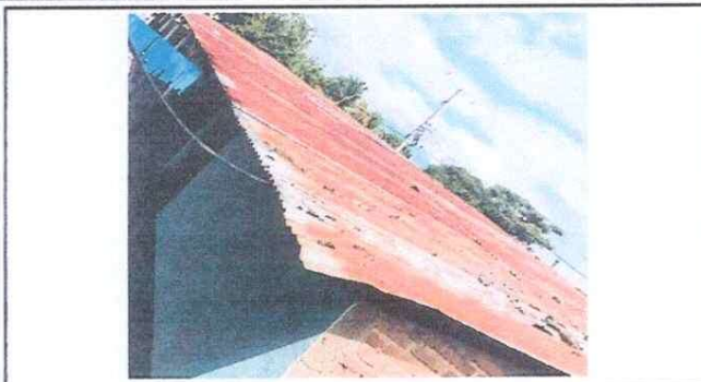
Foto1: Lámina en mal estado, se sustituirá
