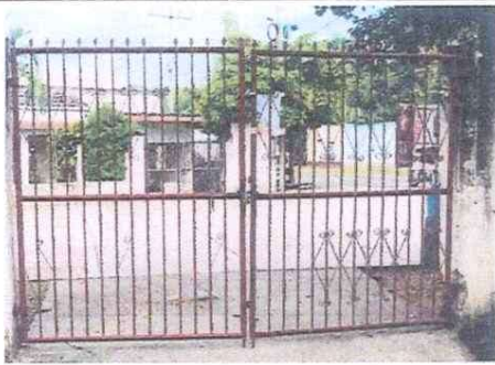
Foto 3: Porton en mal estado, se le dará mantenimiento
