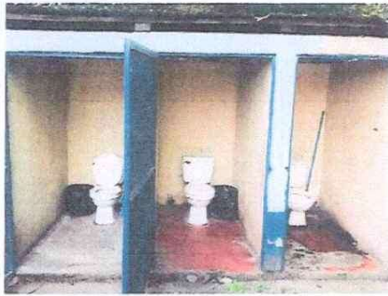
Foto1: Servicios sanitarios en mal estado
