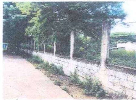
Foto 4: Muro perimetral en mal estado
