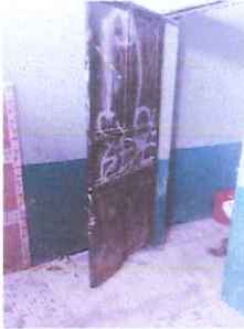
Foto 1: PUERTA: Se cambiará las puertas que estan en mal estado
