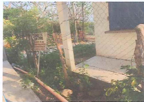
FOTO 4: MURO PERIMETRAL EN MAL ESTADO SE CIRCULARÁ CON VIGA DE CIMENTACION PERALTADA 20 CENTIMETROS ARRIBA DEL NIVEL DEL SUELO NATURAL CON MALLA DE ALAMBRE GALVANIZADO, LA MALLA SE SOSTENDRA EN TUBOS GALVANIZADOS VERTICALES DE 1.50 PULGADAS DE DIAMETRO Y TUBOS PULGADAS DE DIAMETRO Y TUBOS GALVANIZADOS HORIZONTALES DE REMATE DE 1.00 PULGADAS DE DIAMETRO.
