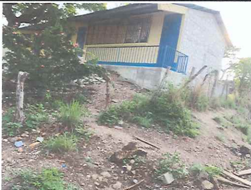
FOTO 3: MURO PERIMETRAL EN MAL ESTADO SE CIRCULARÁ CON VIGA DE CIMENTACION PERALTADA 20 CENTIMETROS ARRIBA DEL NIVEL DEL SUELO NATURAL CON MALLA DE ALAMBRE GALVANIZADO, LA MALLA SE SOSTENDRA EN TUBOS GALVANIZADOS VERTICALES DE 1.50 PULGADAS DE DIAMETRO Y TUBOS PULGADAS DE DIAMETRO Y TUBOS GALVANIZADOS HORIZONTALES DE REMATE DE 1.00 PULGADAS DE DIAMETRO.
