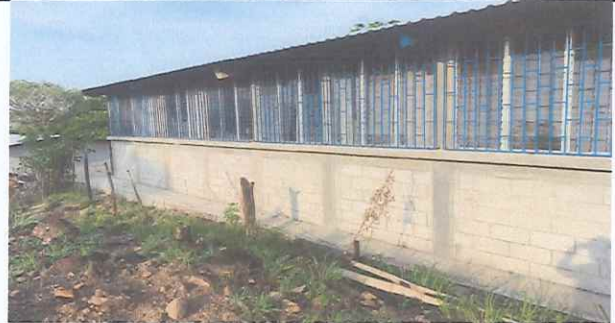
FOTO 2: MURO PERIMETRAL EN MAL ESTADO SE CIRCULARÁ CON VIGA DE CIMENTACION PERALTADA 20 CENTIMETROS ARRIBA DEL NIVEL DEL SUELO NATURAL CON MALLA DE ALAMBRE GALVANIZADO, LA MALLA SE SOSTENDRA EN TUBOS GALVANIZADOS VERTICALES DE 1.50 PULGADAS DE DIAMETRO Y TUBOS PULGADAS DE DIAMETRO Y TUBOS GALVANIZADOS HORIZONTALES DE REMATE DE 1.00 PULGADAS DE DIAMETRO.
