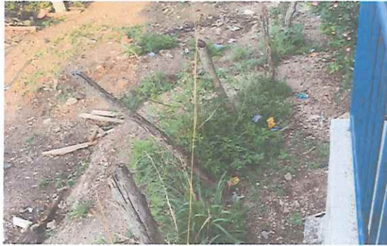
FOTO 1: MURO PERIMETRAL EN MAL ESTADO SE CIRCULARÁ CON VIGA DE CIMENTACION PERALTADA 20 CENTIMETROS ARRIBA DEL NIVEL DEL SUELO NATURAL CON MALLA DE ALAMBRE GALVANIZADO, LA MALLA SE SOSTENDRA EN TUBOS GALVANIZADOS VERTICALES DE 1.50 PULGADAS DE DIAMETRO Y TUBOS PULGADAS DE DIAMETRO Y TUBOS GALVANIZADOS HORIZONTALES DE REMATE DE 1.00 PULGADAS DE DIAMETRO.
