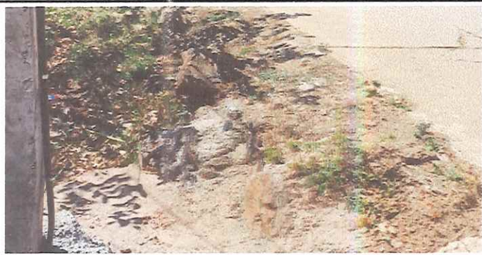
Foto 5: Deterioro de cuneta por la eroción del agua de lluvia
