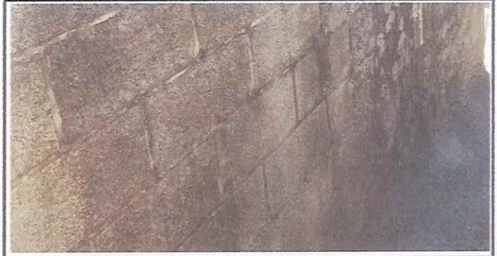
Foto 6: Pared trasera necesita ser impermeabilizada con repello
