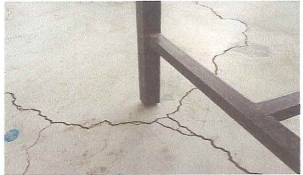
Foto 2: Piso de cemento de las aulas está gretado y avanzando
