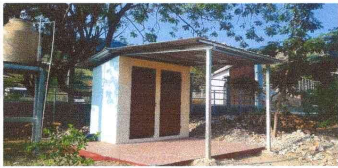
Foto 3: Lámina, soporte de estructura metálica en sanitarios
