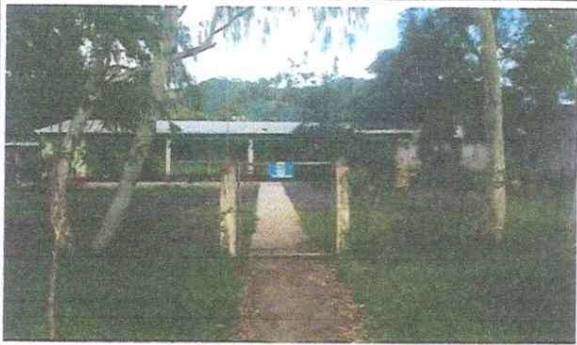
Foto 1: portón principal en mal estado
