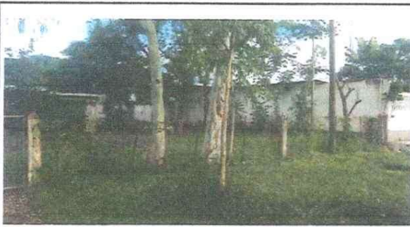
Foto 3: muro perimetral en mal estado
