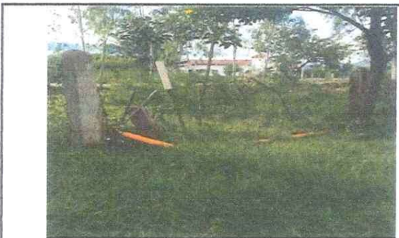
Foto 5: puerta en mal estado
