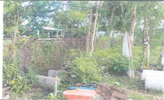
Foto 2: Muro Perimetral en mal estado
