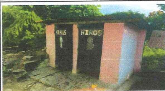
Foto 1: Puertas de los baños en mal estado
