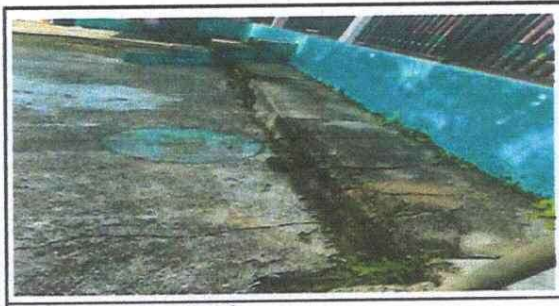
Foto 5: Banqueta en mal estado.
