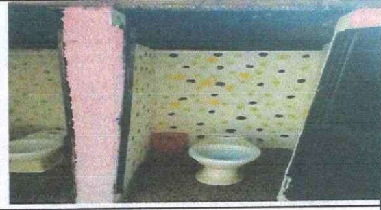
Foto 2: Inodoros en mal estado
