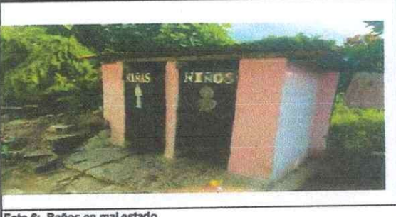
Foto 6: Baños en mal estado.
