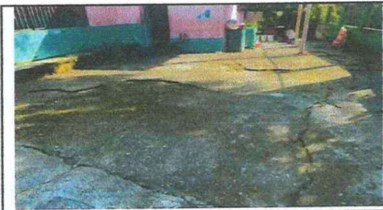
Foto 3: Torta de cemento del patio en mal estado.
