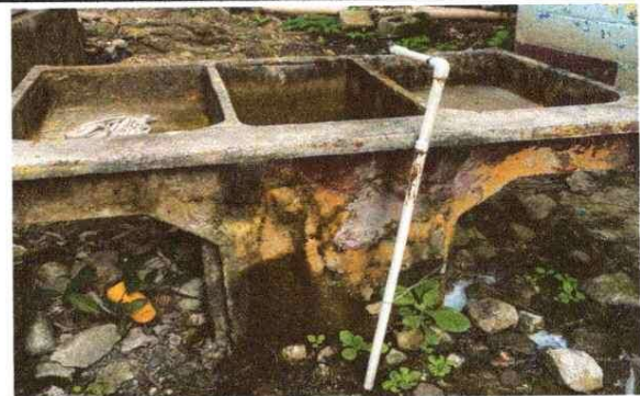
Foto 4: Pila de concreto en mal estado
