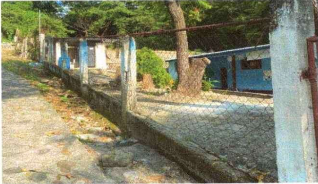
Foto 1: Muro Perimetral en mal Estado
