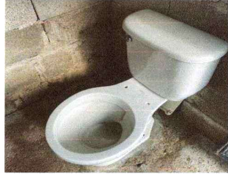
Foto 2: Sustitución de Inodoros, se encuentran en mal estado.
