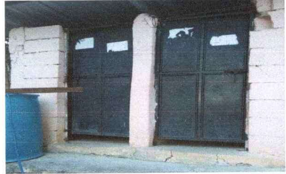
Foto 2: Baños en mal estado
