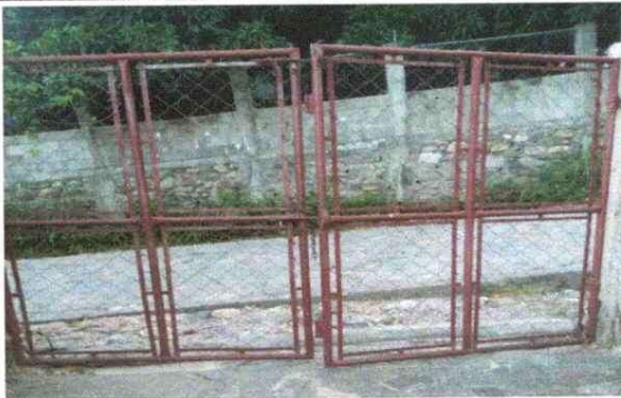
Foto 3: Portón Principal en mal estado
