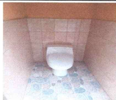
Foto 2: El sanitario dos ya finalizado, nuevo, azulejo, piso y pintado, techo nuevo,
