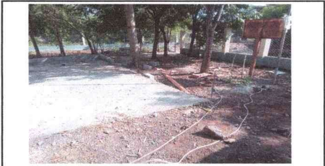
Foto 5: El patio bien deteriorado
