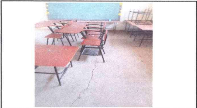
Foto 3: Las aulas deteriorado su concreto con rajaduras
