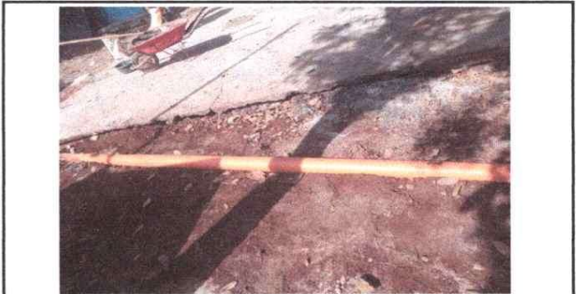
Foto 6: El patio bien deteriorado
