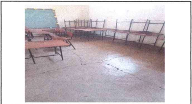
Foto 4: Las aulas deteriorado el concreto con rajaduras
