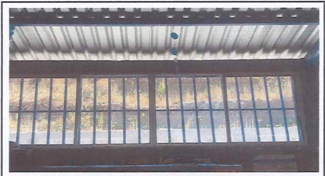
Foto 2: Ventanas con inconvenientes para abrir y cerrar.
