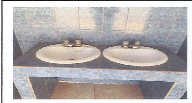
Foto 3: Grifos y mangueras en mal estado.
