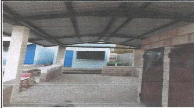
Foto 4: Sustitución de techo de servicios sanitarios y ampliación para área de recepción de alimentos.
