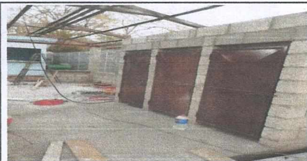
Foto 5: sustitución de techo de área de sanitarios y ampliación para área de recepción de alimentos.
