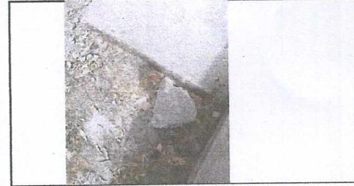
Foto 6: Banqueta del establecimiento en mal estado.
