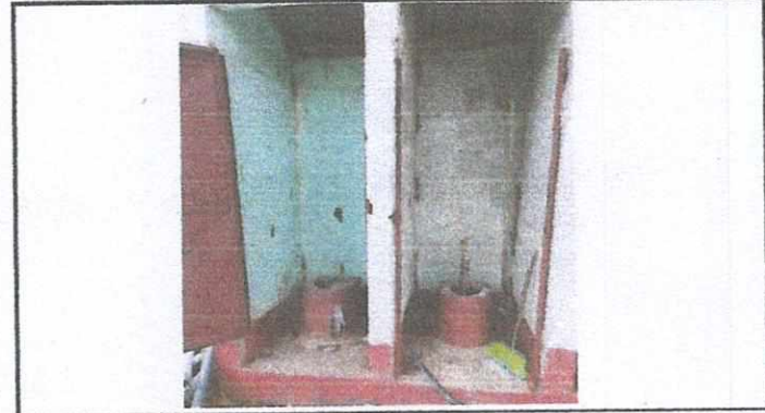
Foto 4: Servicios Sanitarios en mal estado.
