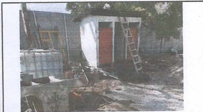
Foto 3: Área de sanitarios, se ampliará, y se colocarán lavamanos para sustituir pila en mal estado.
