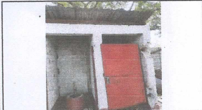
Foto 1: Servicios Sanitarios en mal estado, se sustituirá por sanitarios lavables.
