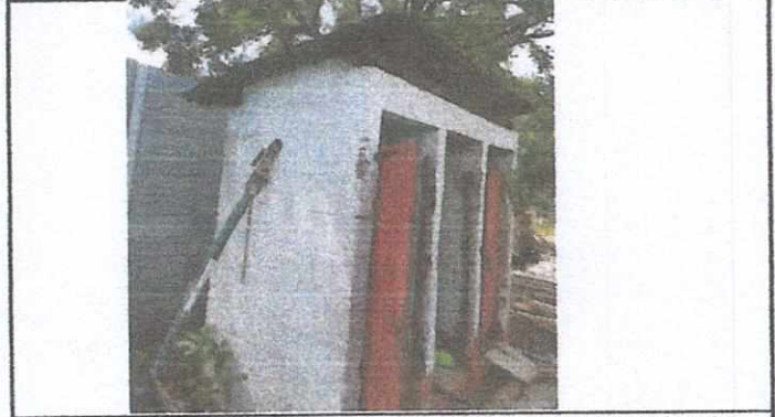
Foto 2: Área de servicios Sanitarios en Mal Estado, se ampliará el techo para evitar humedad.
