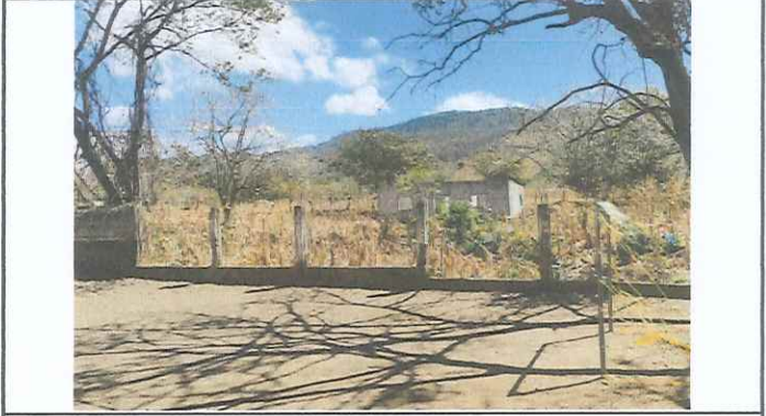
Foto 2: Muro perimetral en mal estado.
