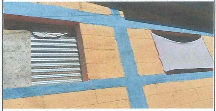
Foto 2: Cocina no posee ventanas
