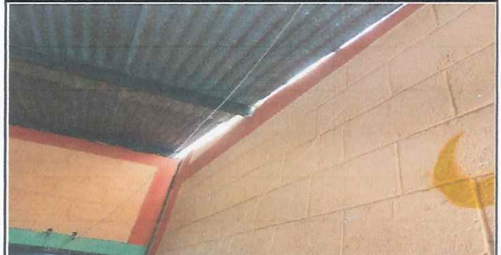
Foto 4: Techo de cocina en mal estado, en época de lluvias se filtra mucha agua, causando inundaciones y dañando mobiliario.
