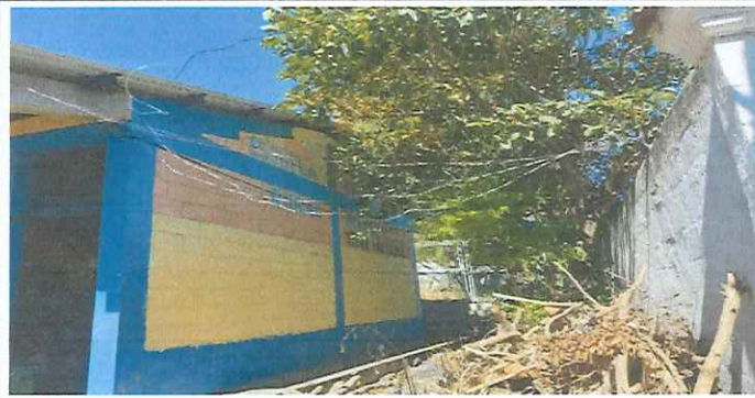
Foto 1: Instalación eléctrica en mal estado.
