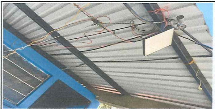
Foto 5: instalación eléctrica en condiciones no adecuadas
