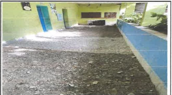
DESPRENDIMIENTO DE REPELLO DE PARTE INTERIOR DE CORREDOR A CAUSA DE FILTRACION.
