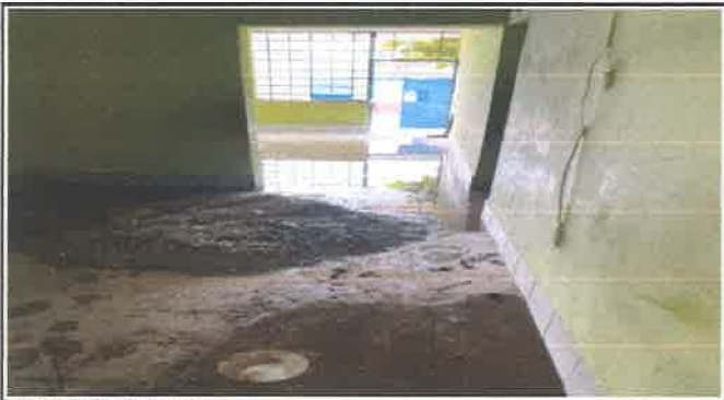
DESPRENDIMIENTO DE REPELLO DE PARTE INTERIOR DE AULAS A CAUSA DE FILTRACION.
