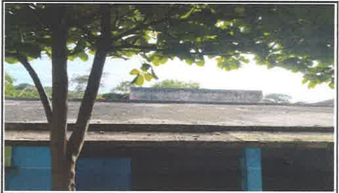
LOSA NECESITA MANTENIMIENTO LIMPIEZA E IMPERMEABILIZACION
