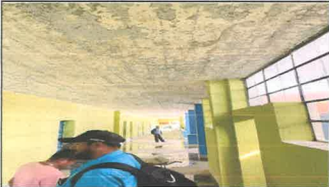
NECESIDAD DE REPELLO EN LOSA PARTE INTERNA DE AULAS Y CORREDOR, DESPRENDIMIENTO DE REPELLO POR FILTRACION DE AGUA.
