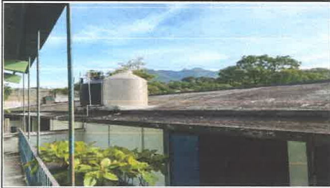
LOSA NECESITA MANTENIMIENTO LIMPIEZA E IMPERMEABILIZACION
