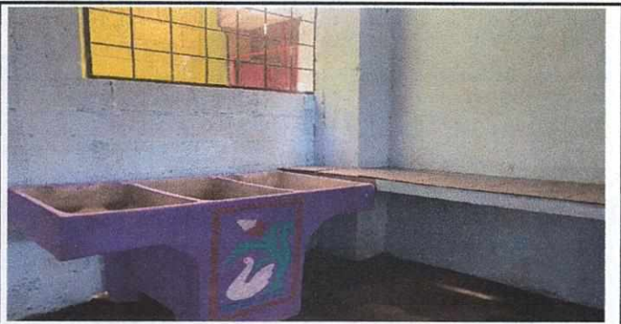
Foto 5: Ventilación externa al área de cocina
