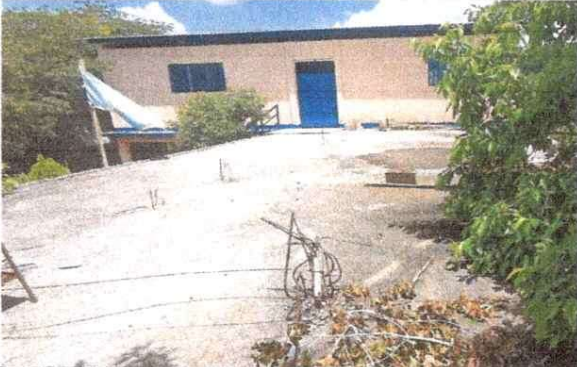
Foto 1: Mejoramiento de terraza aplicando impermeabilizante, y mejorando el nivel del concreto para evitar las filtraciones.
