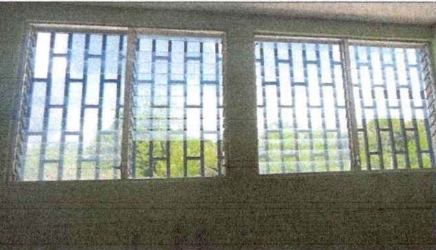
Foto 3: Ventanas del establecimiento en mal estado, se sustituirá por ventanas de PVC.
