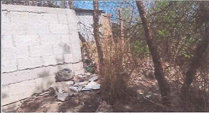
Foto 1: Existe un muro de mampostería sin terminar a un costado del establecimiento.
