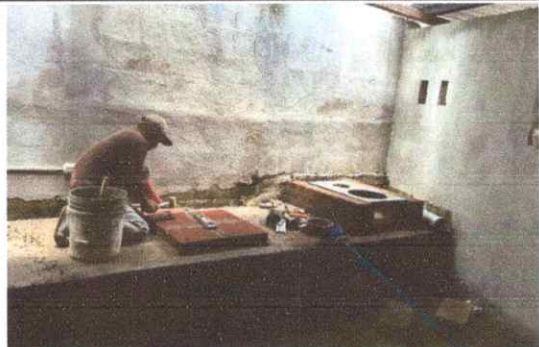
Foto 4: INSTALACIÓN DE TECHO, MEJORAMIENTO DE ESTUFA RURAL, INSTALACIÓN DE PILA, MEJORAMIENTO DE PARED, INSTALACIÓN DE PUERTAS Y VENTANAS, INSTALACIÓN DE PISO E INSTALACIÓN ELECTRICA EN AREA DE COCINA
