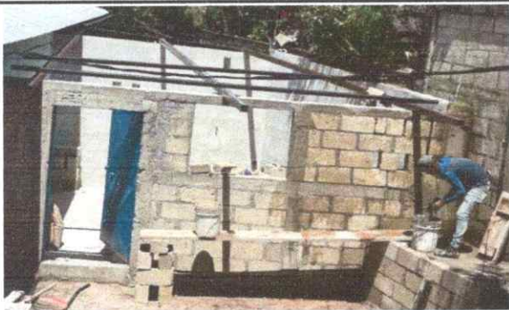
Foto 3: INSTALACIÓN DE TECHO, MEJORAMIENTO DE ESTUFA RURAL, INSTALACIÓN DE PILA, MEJORAMIENTO DE PARED, INSTALACIÓN DE PUERTAS Y VENTANAS, INSTALACIÓN DE PISO E INSTALACIÓN ELECTRICA EN AREA DE COCINA
