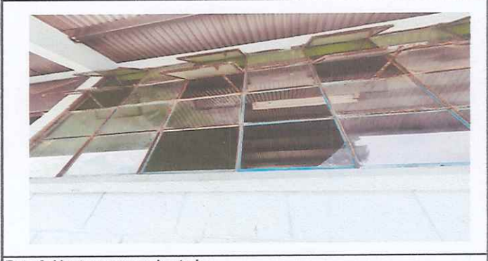
Foto 6: Ventanas en mal estado
