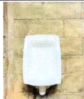
Foto 4: INSTALACIÓN DE TUBERÍA PARA DEPÓSITO DE AGUADEY MINGITORIO CON SUS ACCESORIOS
