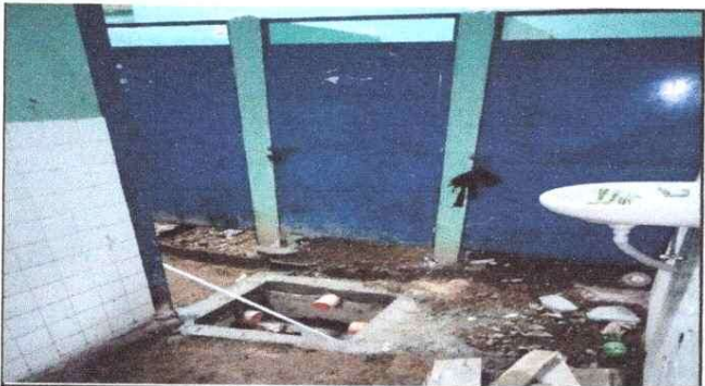
Foto 3: caja de drenaje para servicios sanitarios
