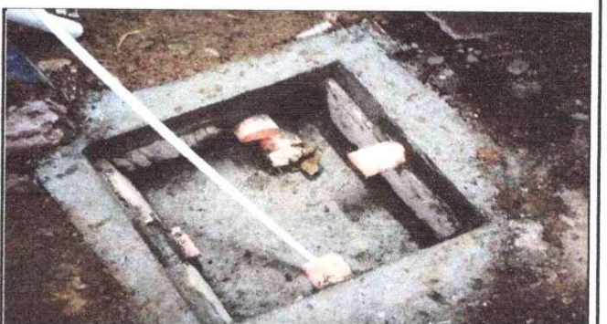
Foto 4: caja de drenaje para servicios sanitarios
