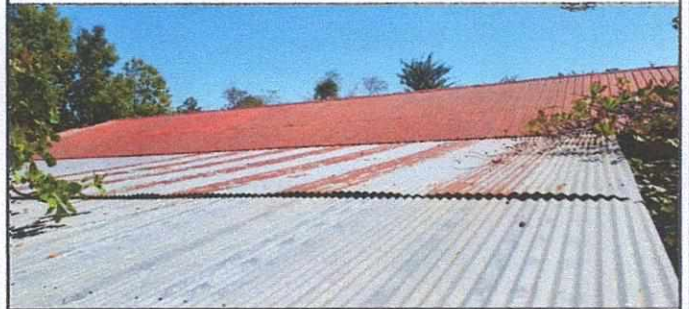
Se necesita mantenimiento de lámina para mas durabilidad
