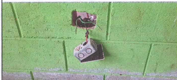
Se necesita cambio de tomacorrientes
