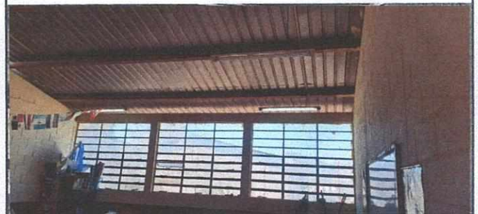
Lamparas de aulas en mal estado, se necesita cambio
