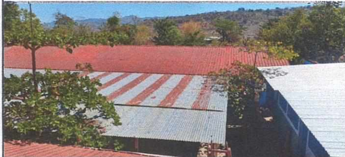
Se necesita mantenimiento de estructura de tcho y mantenimiento de lámina
