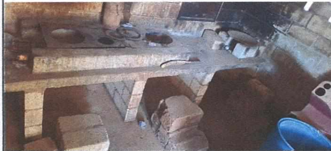
Polleton, piso y repello en cocina en mal estado
