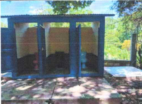
Foto 3: SUSTITUCIÓN DE LETRINAS POR BAÑOS LAVABLES, MEJORAMIENTO DE FOSA SÉPTICAS E INSTALACIÓN DE TUBERÍA PARA DRENAJE EN SERVICIOS SANITARIOS
