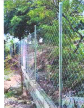
Foto 2: REPARACIÓN DE MURO PERIMETRAL DE BLOCK CON TUBO HG Y MALLA GALVANIZADA, SOLERAS INTERMEDIAS Y COLUMNAS
