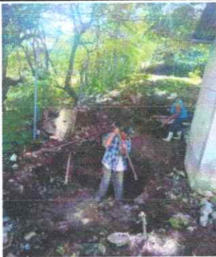
Foto 3: SUSTITUCIÓN DE LETRINAS POR BAÑOS LAVABLES, MEJORAMIENTO DE FOSA SÉPTICAS E INSTALACIÓN DE TUBERÍA PARA DRENAJE EN SERVICIOS SANITARIOS
