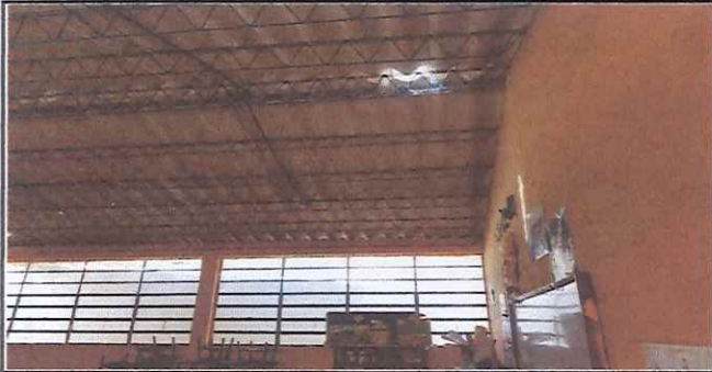
Foto1: Sustitución de techo, ya que se encuentra en mal estado.
