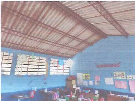
Foto 3: SUSTITUCIÓN TECHO CON DURALITA Y ESTRUCTURA DE METAL POR LÁMINA TROQUELADA EN MODULO DE AULAS
