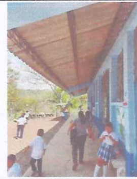
Foto 2: SUSTITUCIÓN TECHO CON DURALITA Y ESTRUCTURA DE METAL POR LÁMINA TROQUELADA EN MODULO DE AULAS
