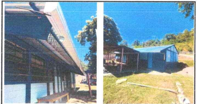
Foto 2: SUSTITUCIÓN DE TECHO DE DURALITA Y TECHO DE LAMINA ACANADALADA CON ESTRUCTURA DE METAL POR LAMINA TROQUELADA CALIBRE 26
