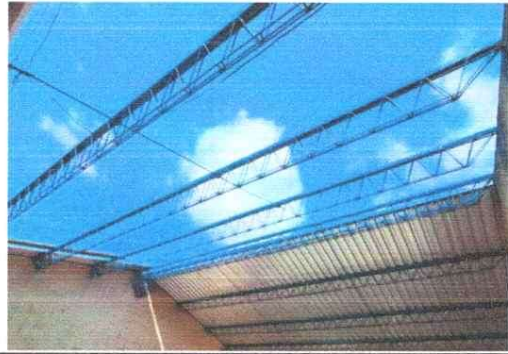
Foto 2: SUSTITUCIÓN DE TECHO DE DURALITA Y TECHO DE LAMINA ACANADALADA CON ESTRUCTURA DE METAL POR LAMINA TROQUELADA CALIBRE 26
