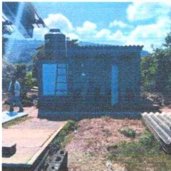
Foto 3: SUSTITUCIÓN DE TECHO, SUSTITUCIÓN DE LETRINAS POR BAÑOS LAVABLES Y SUS ACCESORIOS, MEJORAMIENTO DE FOSA SEPTICA Y DRENAJES EN SERVICIOS SANITARIOS
