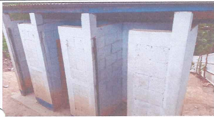
Foto 7. Pintura en paredes de baños
