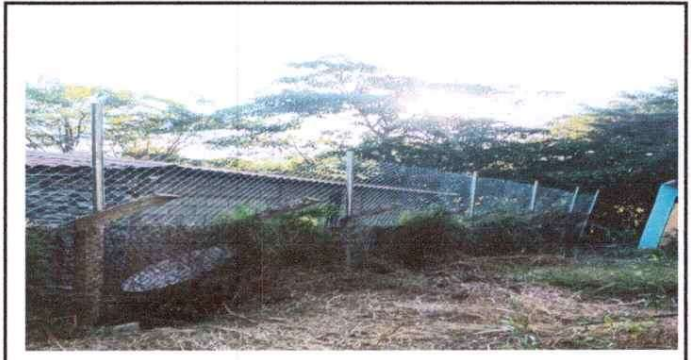
Foto 2: Tapial de maya sobre tapial de mamposteria
