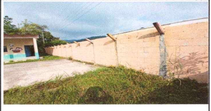
Foto 2: Tapial de maya sobre tapial de mamposteria
