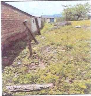
Foto 1: Lado izquierdo más dañado, remozar con tapial de block.
