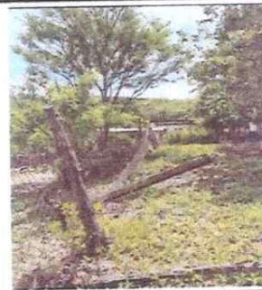
Foto 4: Instalación a remozar por daños.
