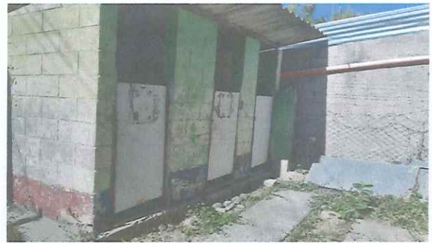
Foto 4: Puertas de baño
