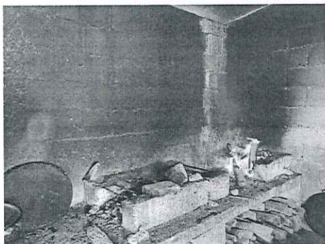
POLLETON EN MAL ESTADO
