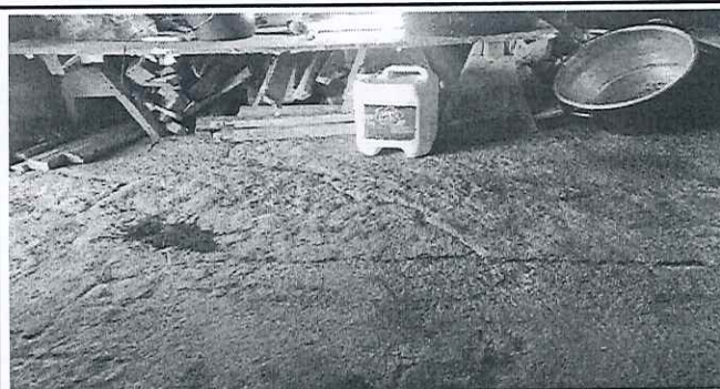
PISO DE COCINA CON FISURAS
