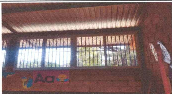
Foto 1: Instalacion de ventanas de pvc color blanco, corredizas, vidrio bronce claro, y cedazo para mosquitero.
