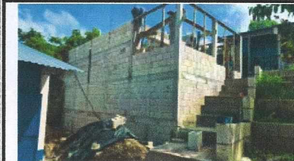
Foto 1: SUSTITUCIÓN TECTO, MEJORAMIENTO DE PAREDES, SUSTITUCIÓN DE ESTUFA RURAL, SUSTITUCIÓN DE PISO, INSTALACIÓN DE PUERTA E INSTALACIÓN DE ESTRUCTURA DE METAL DE VENTANA EN AREA DE COCINA
