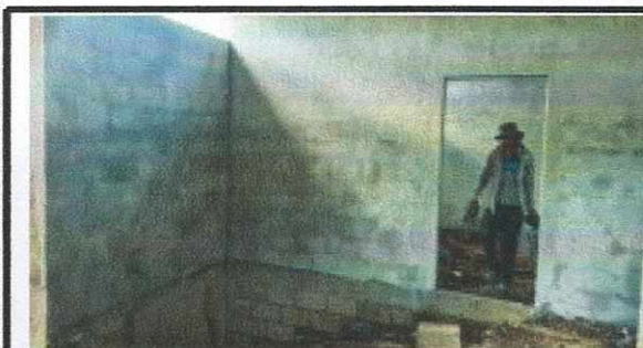
Foto 5: SUSTITUCIÓN TECTO, MEJORAMIENTO DE PAREDES, SUSTITUCIÓN DE ESTUFA RURAL, SUSTITUCIÓN DE PISO, INSTALACIÓN DE PUERTA E INSTALACIÓN DE ESTRUCTURA DE METAL DE VENTANA EN AREA DE COCINA
