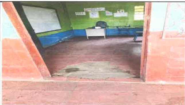
PISO DE AULAS EN MAL ESTADO
