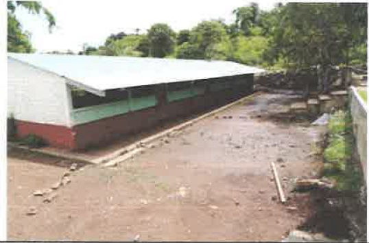
MODULO DE AULAS CON DAÑOS EN SISTEMA ELECTRICO Y ACCESIBILIDAD AL MISMO
