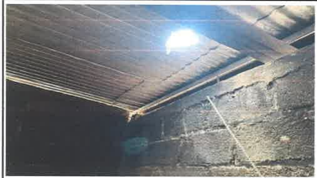
TECHO DE COCINA EN MAL ESTADO
