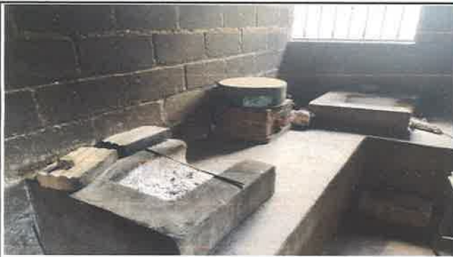
ESTUFA RURAL EN MAL ESTADO, MURO DE COCINA NECESITAN LIMPIEZA Y MEJORAMIENTO
