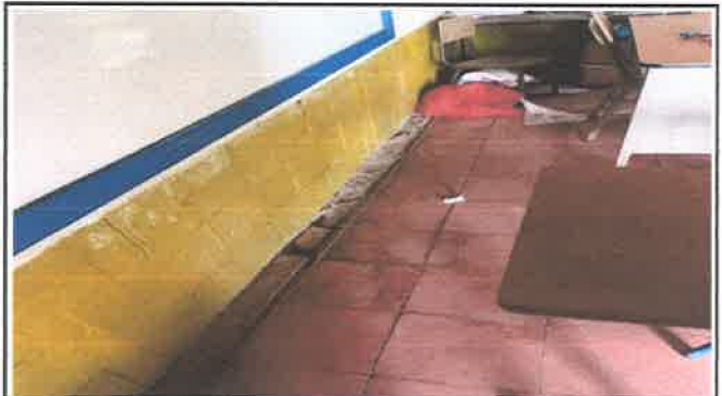
PISO DE AULAS EN MAL ESTADO
