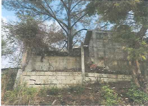
Foto 1: Área más afectada por greta en muro.
