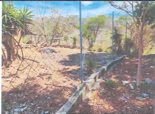
Foto 1: REPARACIÓN DE MURO PERIMETRAL DE BLOCK CON TUBO HG Y MALLA GALVANIZADA, SOLERAS INTERMEDIAS Y COLUMNAS
