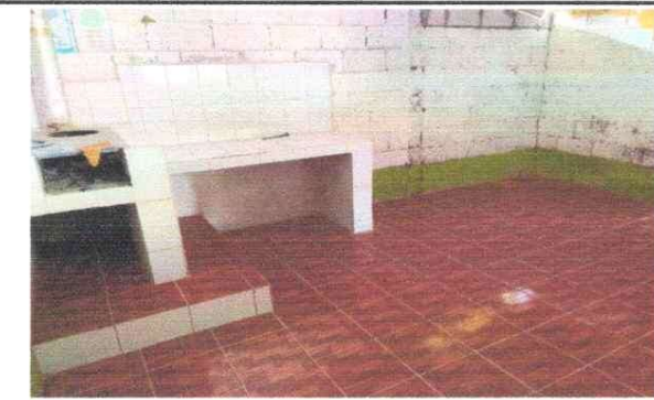
Foto 3: SUSTITUCIÓN DE ESTUFA RURAL CON CHIMENEA, PLANCHA DE METAL E INSTALACIÓN DE AZULEJO Y MUEBLE DE COCINA MAS INSTALACIÓN DE AZULEJO EN AREA DE COCINA.
