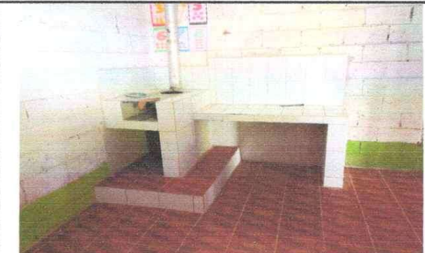
Foto 4: SUSTITUCIÓN DE ESTUFA RURAL CON CHIMENEA, PLANCHA DE METAL E INSTALACIÓN DE AZULEJO Y MUEBLE DE COCINA MAS INSTALACIÓN DE AZULEJO EN AREA DE COCINA.
