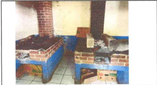
Foto 3: SUSTITUCIÓN Y MEJORAMIENTO DE ESTUFA RURAL CON CHIMENEA, PLANCHA DE METAL E INSTALACIÓN DE AZULEJO, MUEBLE DE COCINA MAS INSTALCIÓN DE AZULEJO EN AREA DE COCINA.
