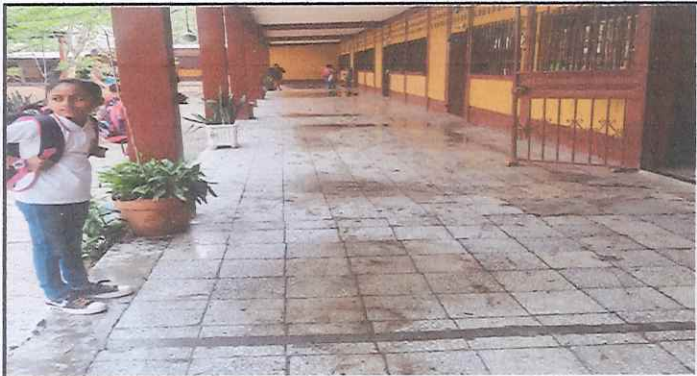
Foto 3: Filtración de agua llovediza por mal estado del techo
