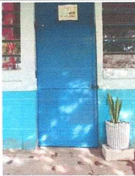
Foto 9: MANTENIMIENTO A ESTRUCTURA (LIJADO, CAMBIO DE TUBO , CEPILLADO, SUJECIONES, APLICACIÓN DE PINTURA) EN PUERTA
