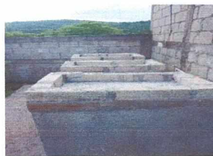
Foto 6: MEJORAMIENTO DE PILA DE CEMENTO Y REPARACIÓN DE TUBERIA PVC DE AGUA POTABLE
