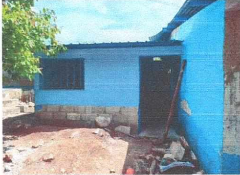
Foto 7: SUSTITUCIÓN DE TECHO, MEJORAMIENTO DE PARED DE BLOCK, PINTURA EN MUROS INTERIORES Y EXTERIORES E INSTALACIÓN DE ESTRUCTURA DE METAL EN VENTANA EN AREA DE COCINA
